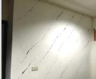
RC牆斜向裂縫
